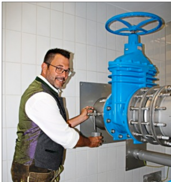
Bürgermeister Martin Öttl freut sich über die erstklassige Qualität des Ainringer Trinkwassers.
